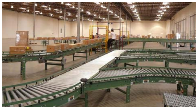
convoyeur / trieur installé dans un entrepôt de cross-docking
